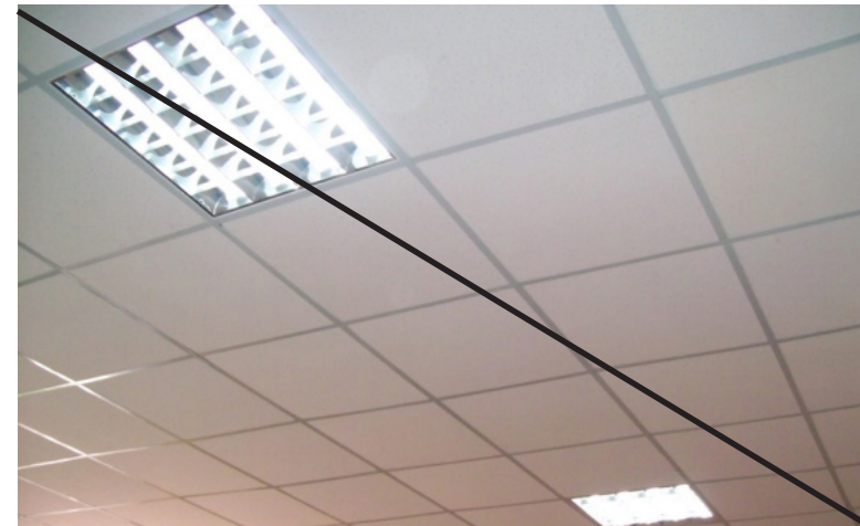
Плохо Открытые направляющие
